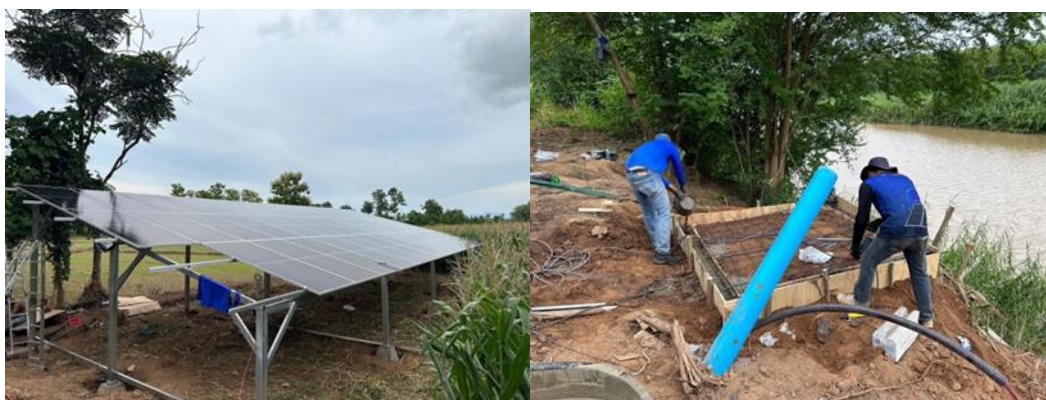
ภาพที่ ๔.๒๒ องค์กรผู้ใช้น้ำฯ บ้านวังพ่อน และกลุ่มผู้ใช้น้ำร่องแดงติดตั้งระบบโซลาร์เซลล์
